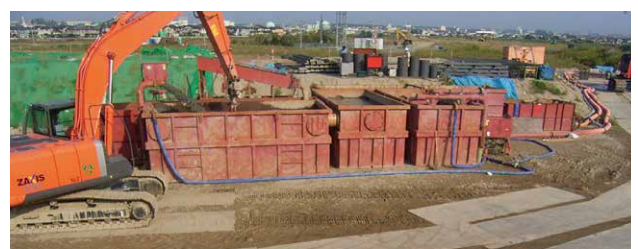
▲スラッシュコンテナ(残土沈殿水槽)
